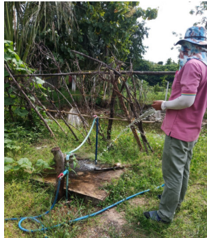
จุดที่ ๑ ถึงสูง ระบบประปา
