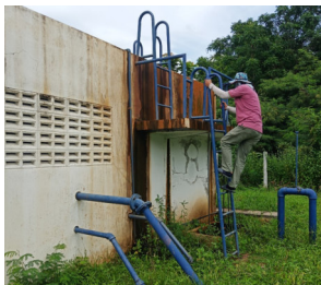
จุดที่ ๑ ระบบประปา
